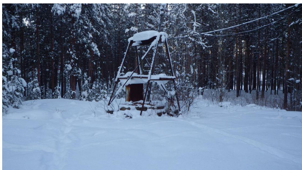
Рисунок 17. Канализационная насосная станция по ул. Мира (КНС № 3)
