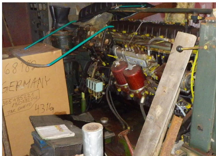
Рисунок 13. Дизельный электрогенератор Germany
