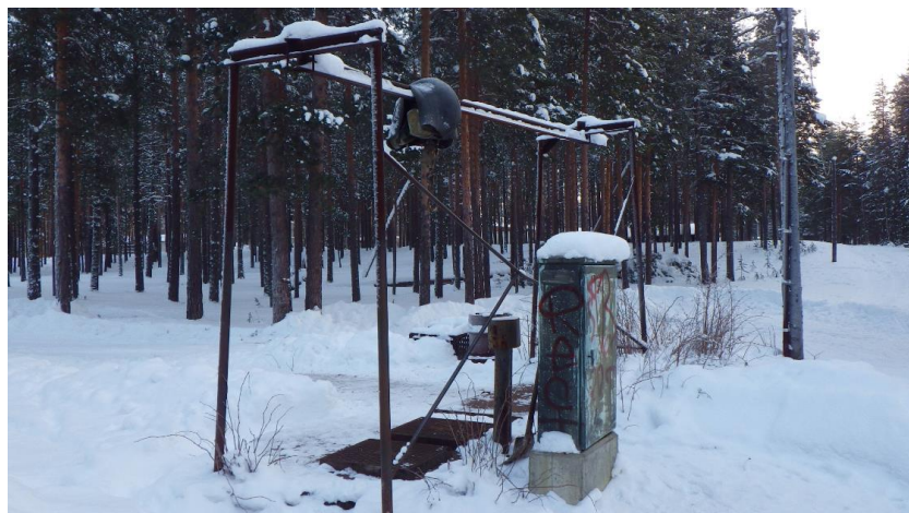
Рисунок 16. Канализационная насосная станция по ул. Дружбы (КНС № 2)
